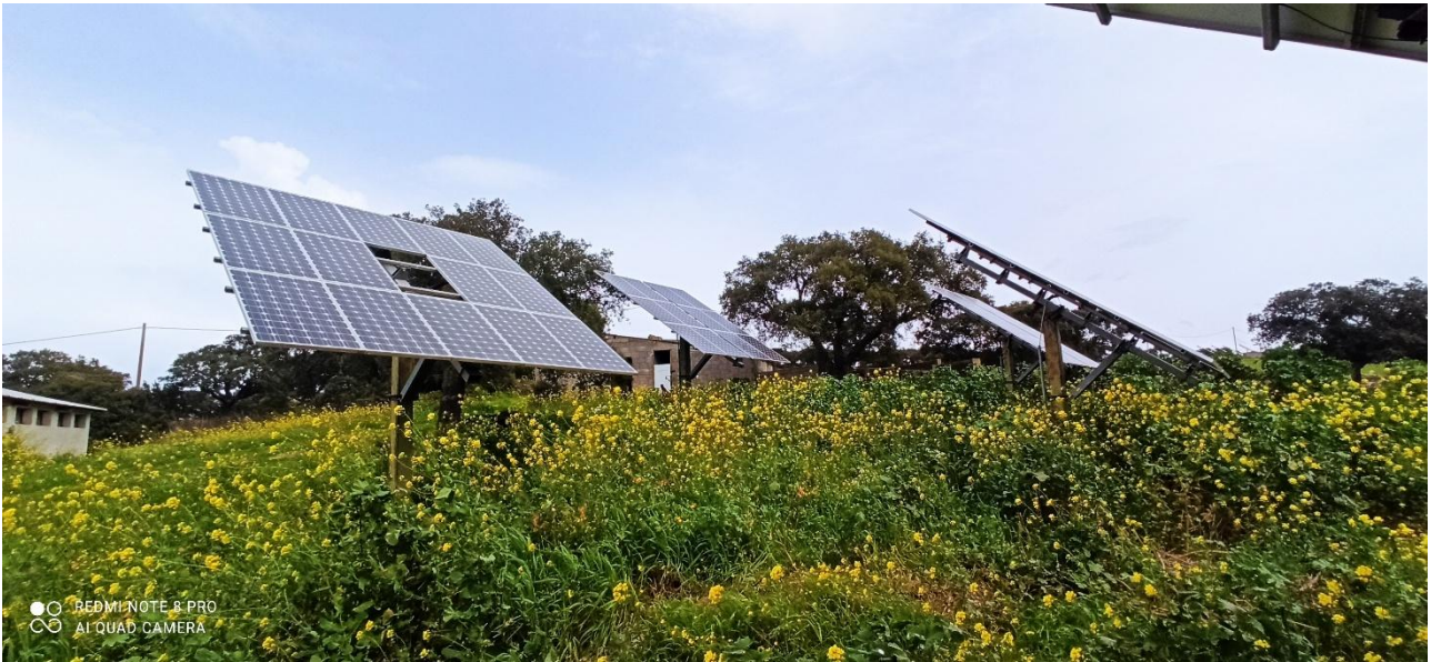
Foto n.84 vista pannelli fotovoltaici zona sud-ovest
